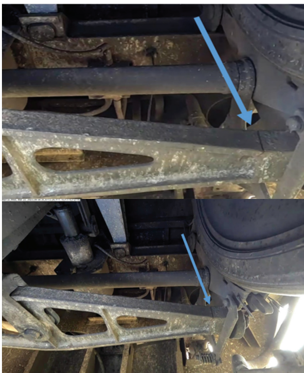
Slika 5. Defekt naprsnuća trougaone motke uočen na pregledu lokomotive 444-006
