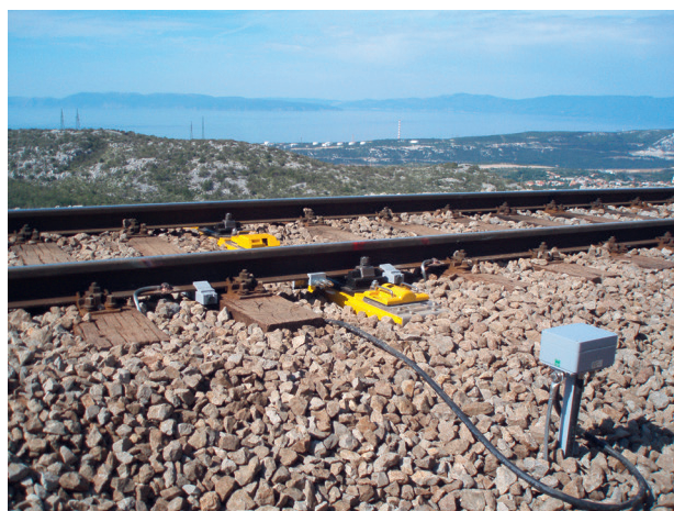
Slika 10: „Hot box“ sustav ugrađen na lokaciji ŽCP Milja
