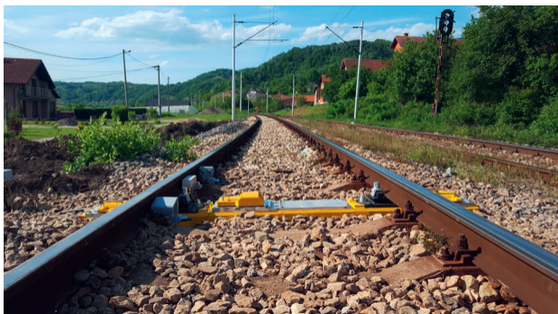
Slika 12: „Hot box“ sustav ugrađen na lokaciji Doboje
