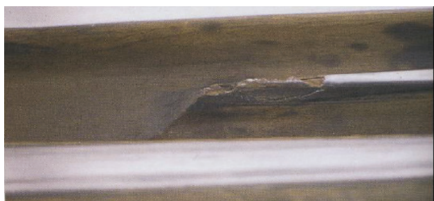
Slika 12. Oštećenje vrha srca ukrštaja [4]
