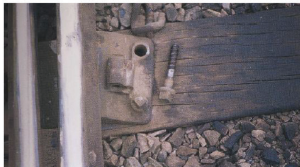
Slika 7. Polomljena podložna ploča [4]
