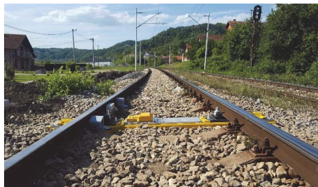
Slika 14. „Hotbox” sistem ugrađen na lokaciji Doboj [14]
